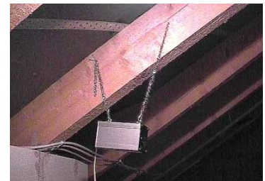
z.B.: Aufhängung im Dachboden Scheuchen in 1 Richtung
